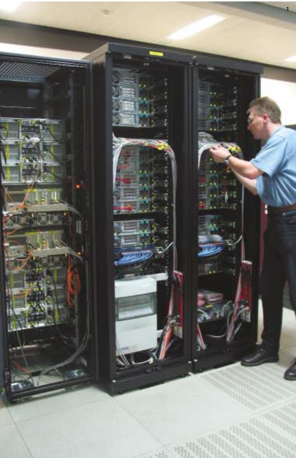
1 Hochverfügbares Mail-Cluster-System des MWN (Münchener Wissenschaftsnetz). High-availability mail cluster system of the MWN.
