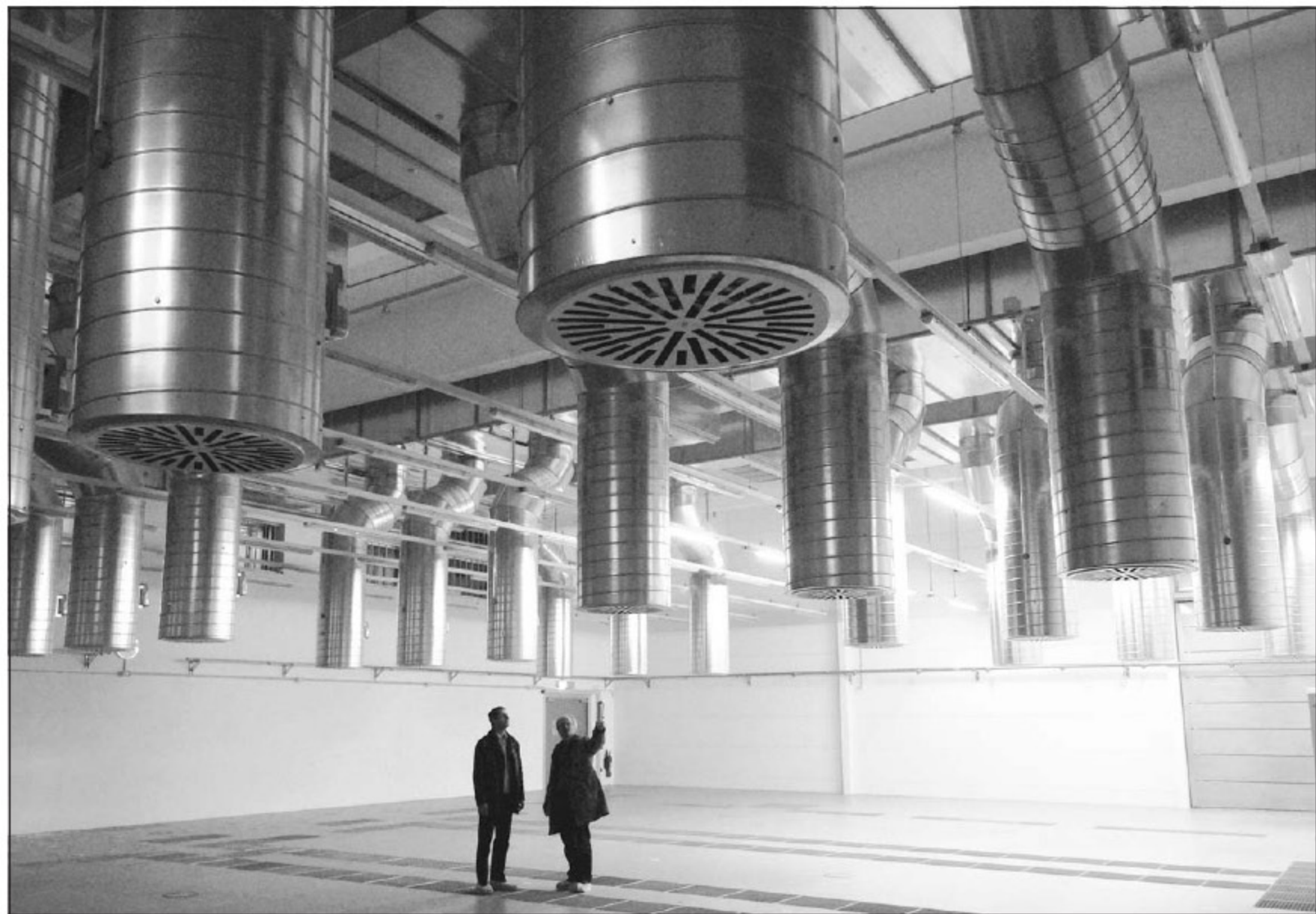
In der großen Halle mit Ventilatoren an der Decke werden die Computer des Leibniz-Rechenzentrums auf dem Campus Garching untergebracht.
